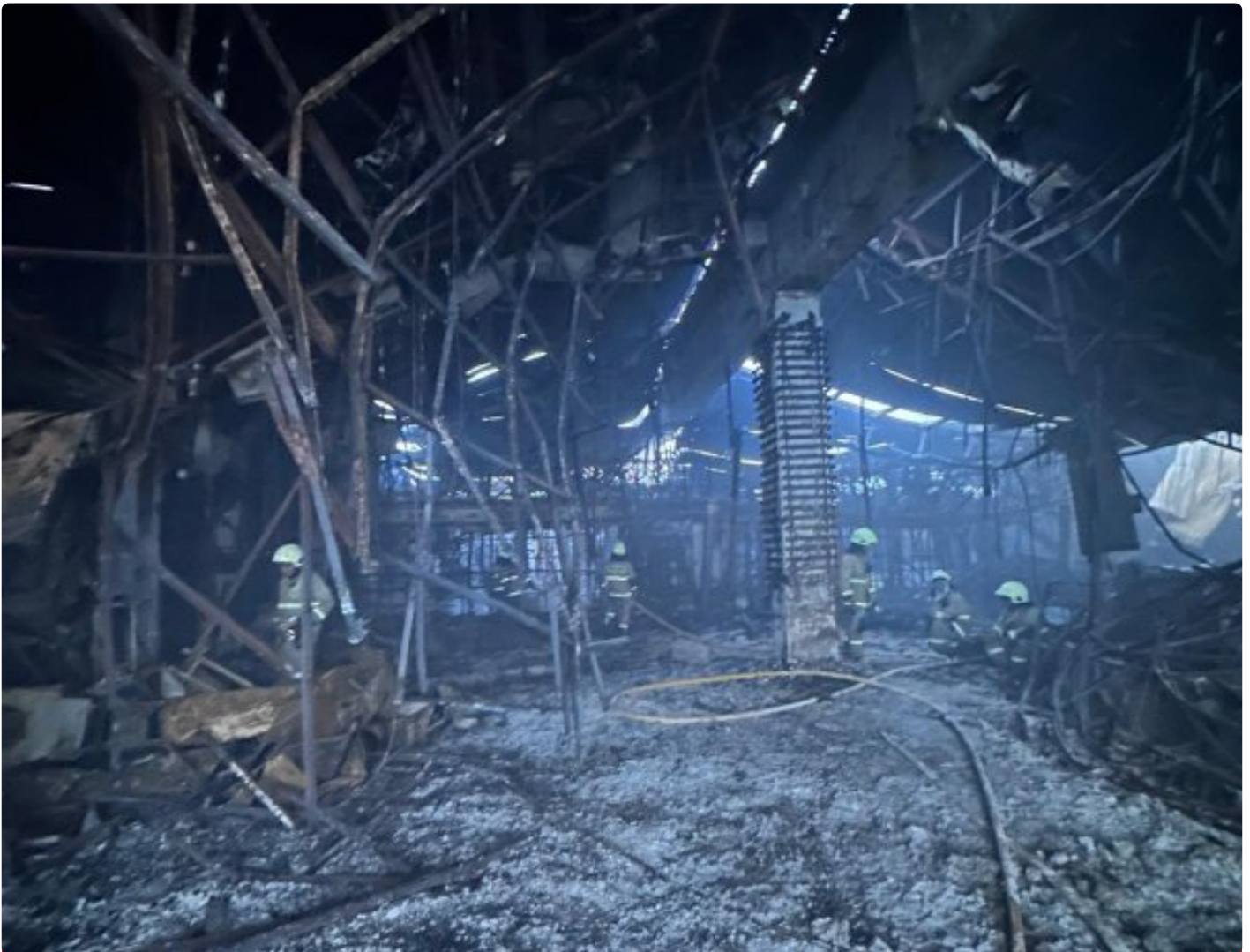
Glodok Plaza yang Hangus Terbakar
